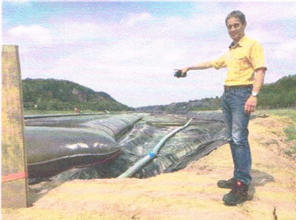
Bis zu 70 Meter lang sind die Schläuche, in die der Schlamm aus dem Hafenbecken gepumpt wird. „Das Wasser läuft zurück in die Elbe, was übrig bleibt, kommt auf die Deponie“, erklärt Christoph Oehme vom Wasserstraßen- und Schifffahrtsamt Dresden.
